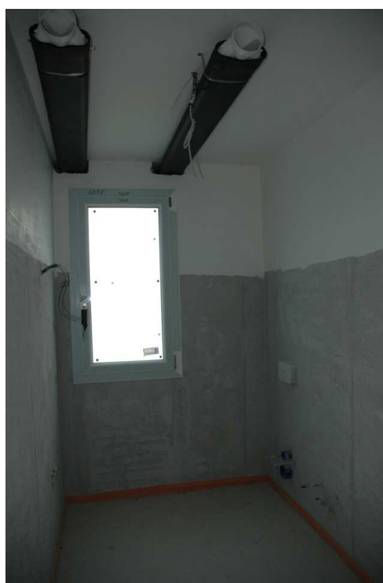
Foto 52 - Nei bagni è predisposto il sistema di ricircolo dell'aria.
