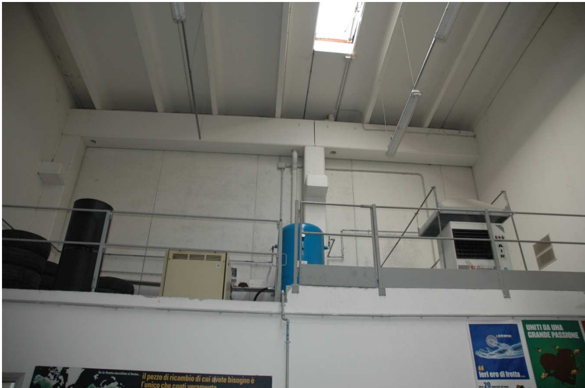
Foto 83 – Il capannone è in buono stato e gli impianti risultano a norma con le vigenti normative.
