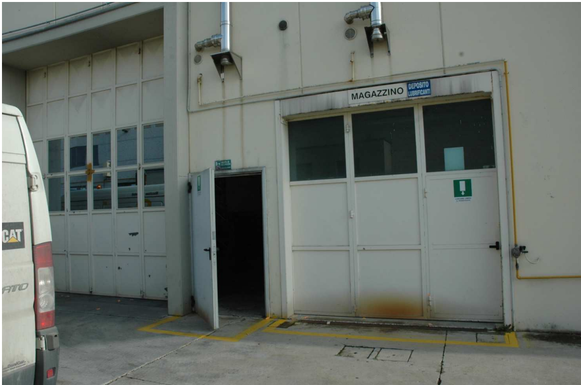
Foto 87 – All'esterno una porta in metallo di accesso alla centrale termica.
