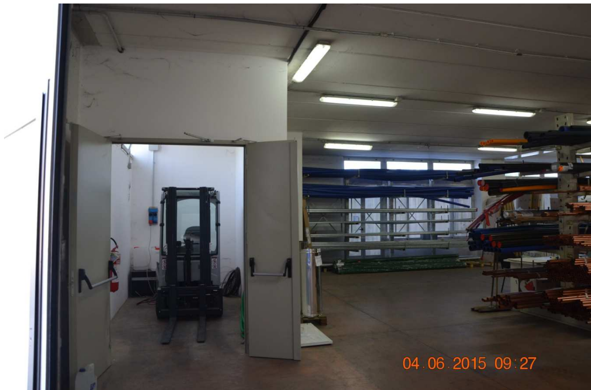
Foto 27 - All'interno con il pavimento in cemento industriale un locale per la ricarica dei muletti, che necessita di interventi di manutenzione.
