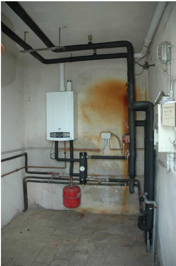
Foto 88 – Centrale termica con caldaia.
