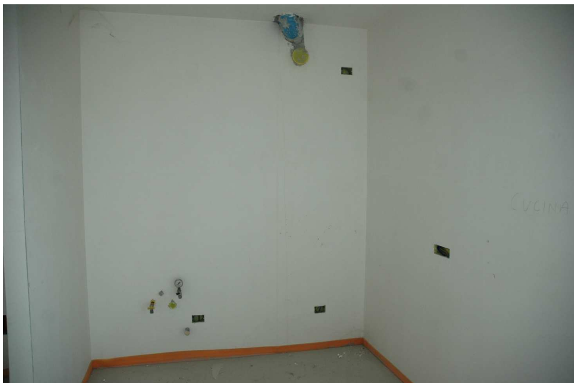
Foto 49 - Angolo cottura con tutti gli impianti predisposti, il riscaldamento è a pannelli radianti nel pavimento.
