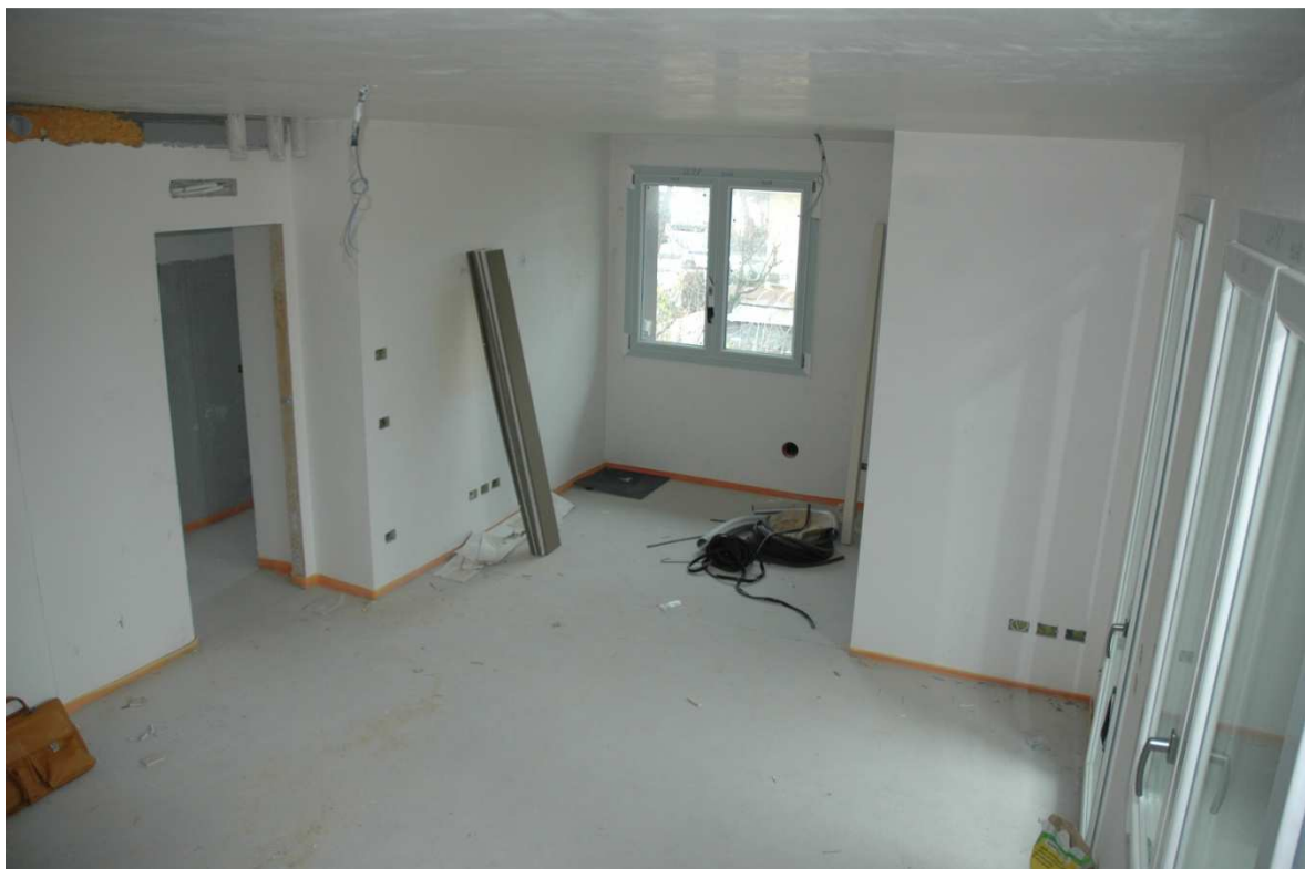
Foto 62 – All'interno mancano ancora delle opere che sono state conteggiate in riduzione del prezzo.
