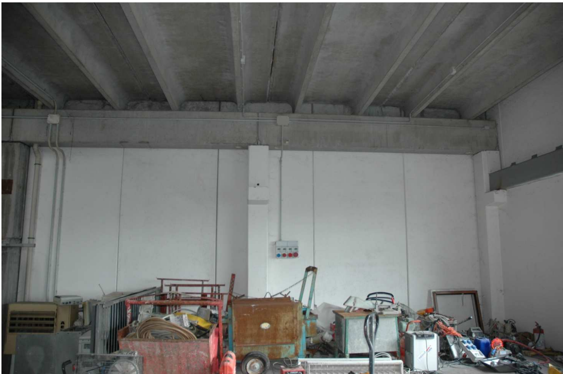
Foto 93 – Il locale è facilmente accessibile dalla corte, gli impianti sono a vista in canaline a norma con le vigenti normative dell'epoca.
