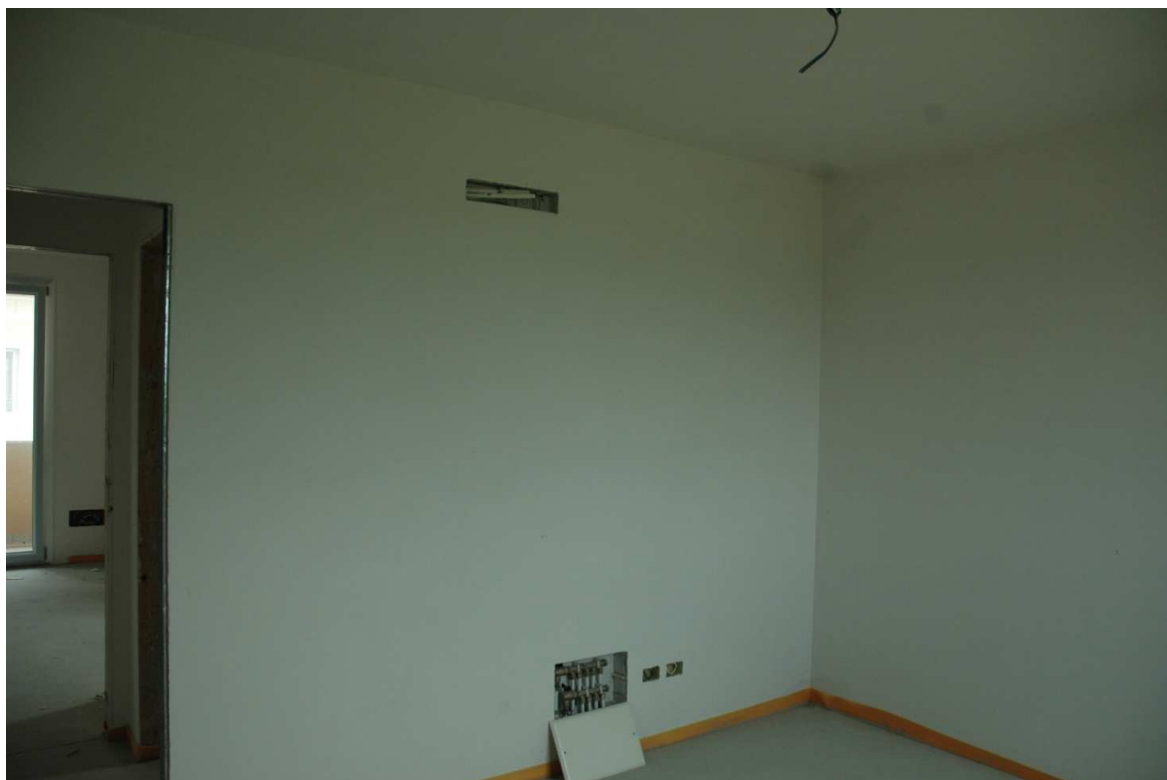
Foto 50 - Vi è la predisposizione per l'aria condizionata
