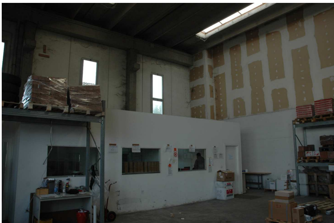
Foto 97 – Questa porzione del capannone ha l'ingresso sul retro dal piazzale destinato a parcheggio pubblico. All'interno è stato ricavato, in materiale leggero, un locale ad uso ufficio, privo di autorizzazione. Sulla parete si nota la presenza dei pannelli di cartongesso ancora privi di rasatura e tinteggiatura nella parte superiore.
