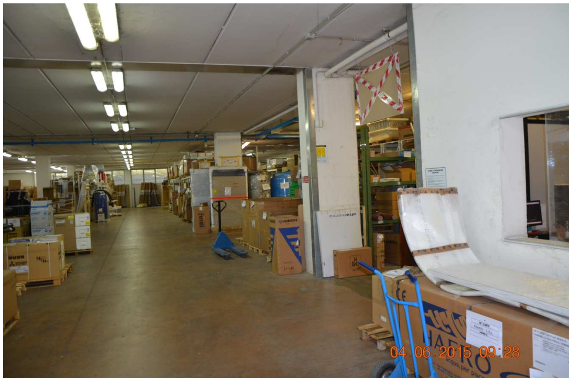
Foto 28 - Sulle pareti laterali a partire da circa cm. 200 una lunga finestrazione, gli impianti sono a vista.
